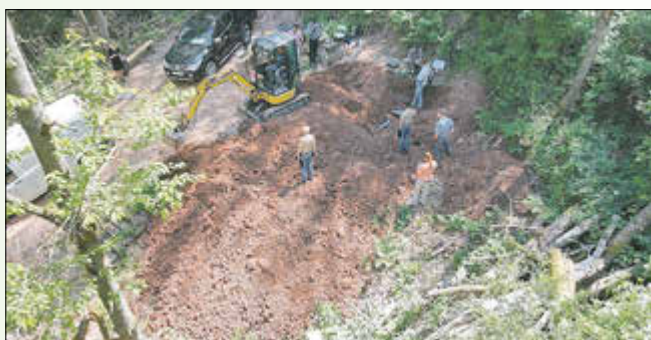
Bisherige Grabfläche im Richelsdorfer Tal u. a. mit den Mitarbeitern des Bauhofs Herr Issleib, Herr Regenspurger, Herr Klatt und Herr Stück
